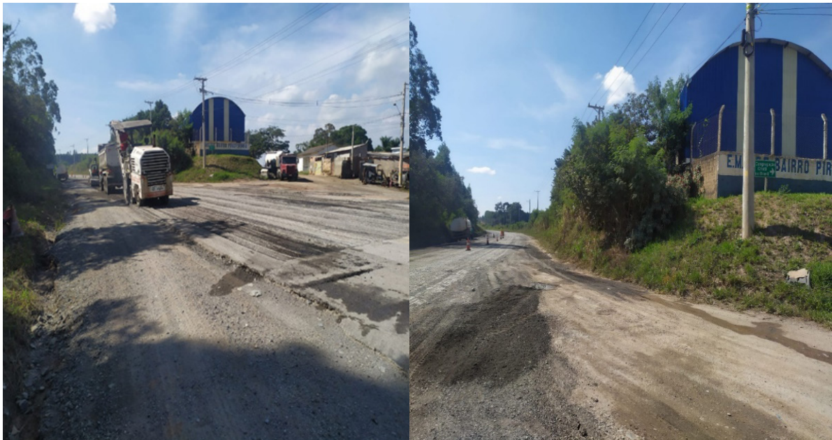
Figura 2. Recapeamento da rodovia e melhoria do acostamento nas proximidades da escola do bairro Piraporinha. Fonte: dos autores.
