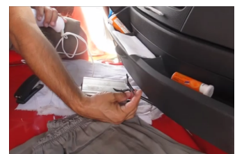
Figura 14. Instalação elétrica improvisada.
